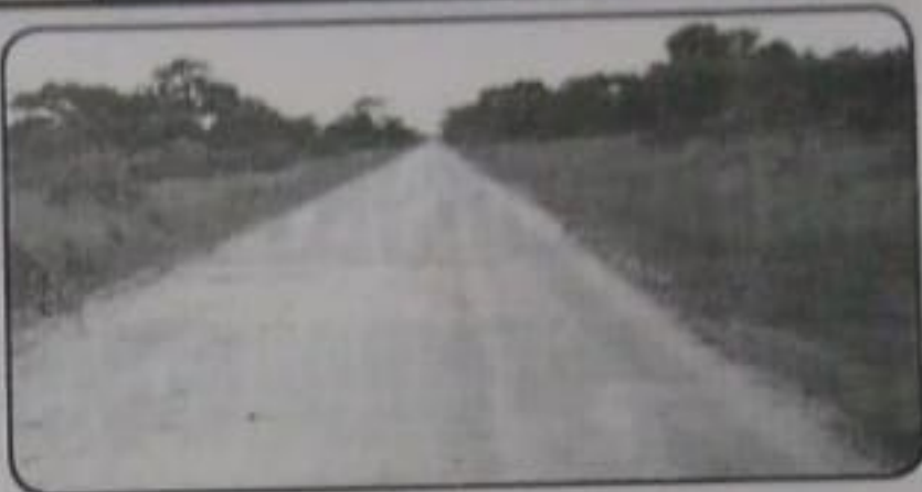
A estrada actual não está asfaltada
